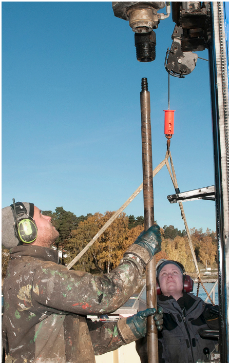
Kompletterande geotekniska undersökningar i Landsortsfarleden görs av Olle Engberg och Marie Berglund.
