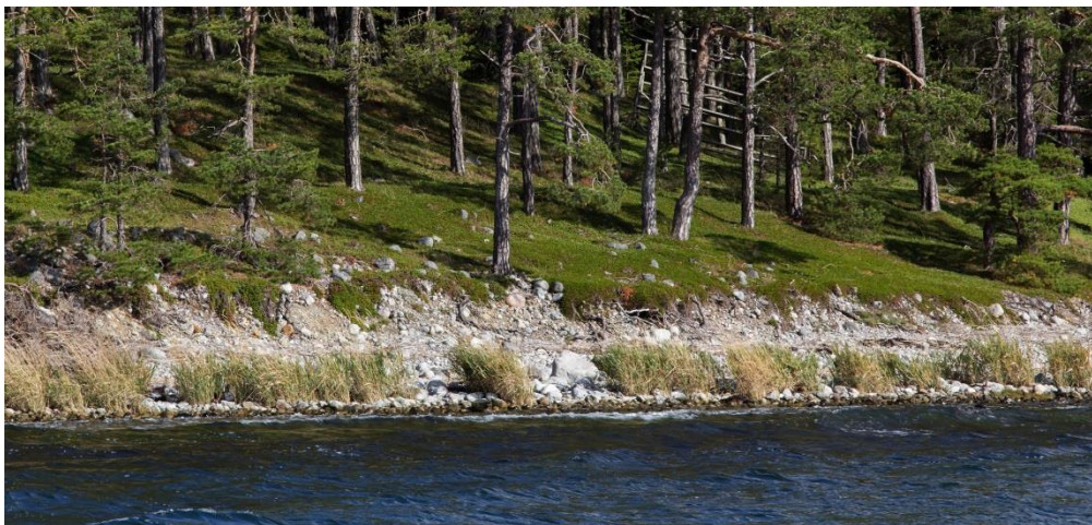
Figur 33. Erosionsproblem längs västra sidan av Regarn.
