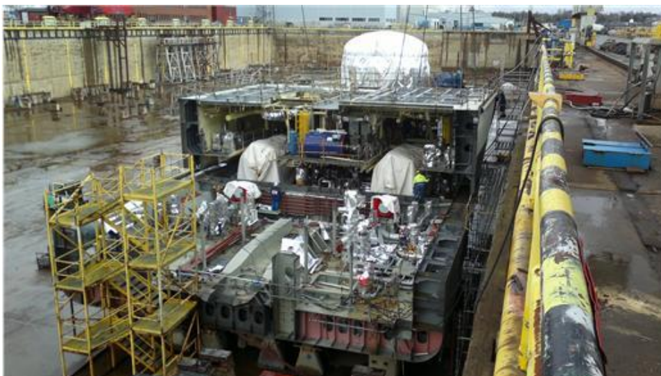
Figur 2.2 LNG-tank (vit) vid installationen på Turva vid varvet i Raumo. Bild: www.raja.fi
