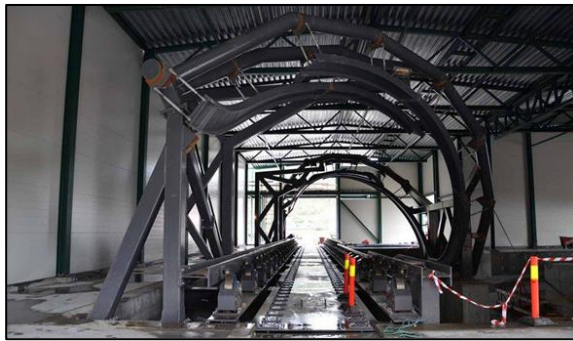
Figur 7.3.1.2 Northland Resources lossningsanläggning för sidotippade vagnar i Narvik. Elektrifierade lok kan ej köra igenom.
